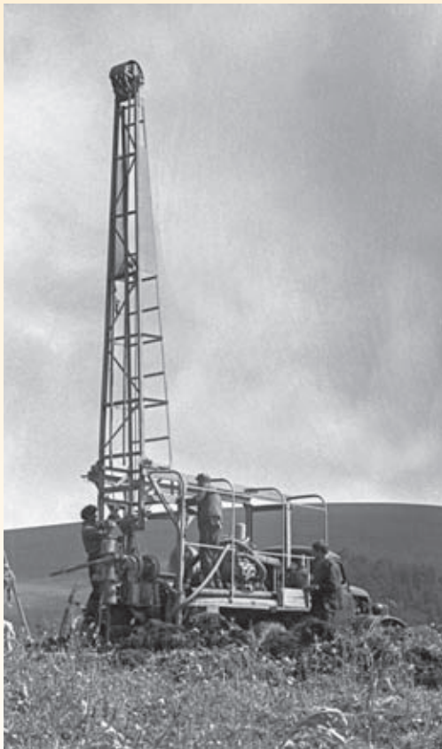
Бурение первой скважины для исследования скальных пластов на месте строительства БТА. 1965 г.
