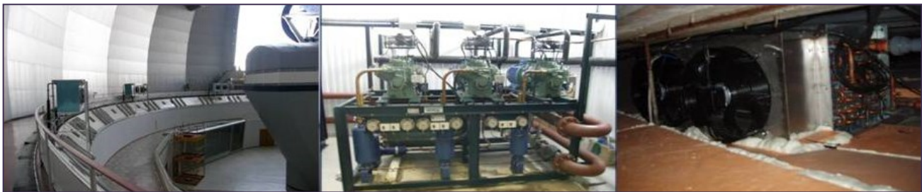
Рис. 11. Система охлаждения подкупольного пространства БТА. Слева - ВОП (воздухообменный прибор) в подкупольном и подпольном пространстве; в центре - три компрессорных фреоновых агрегата мощностью по 30 кВт; справа - теплообменные емкости, сетевые насосы, система трубопроводов.
