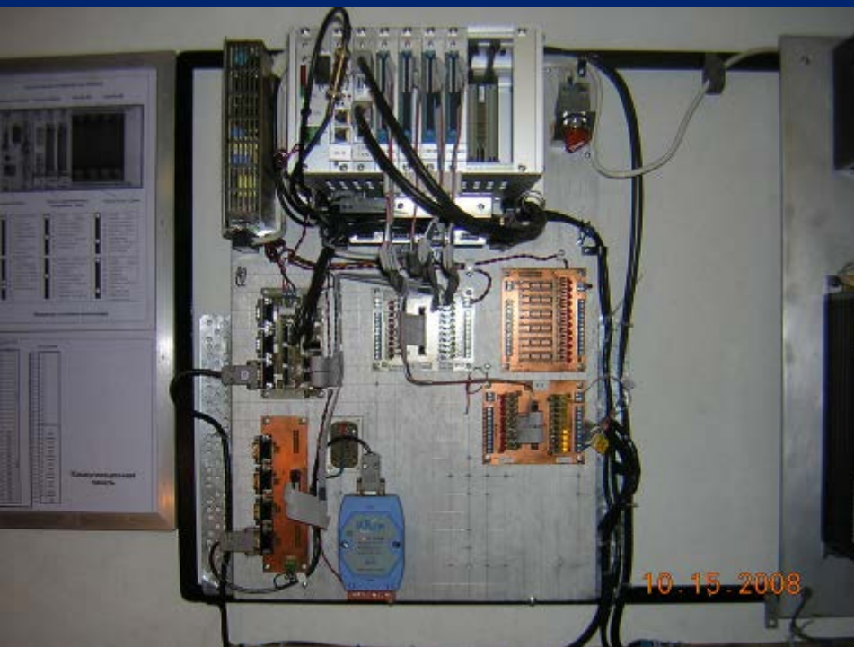
Общий вид азимутального узла после модернизации
