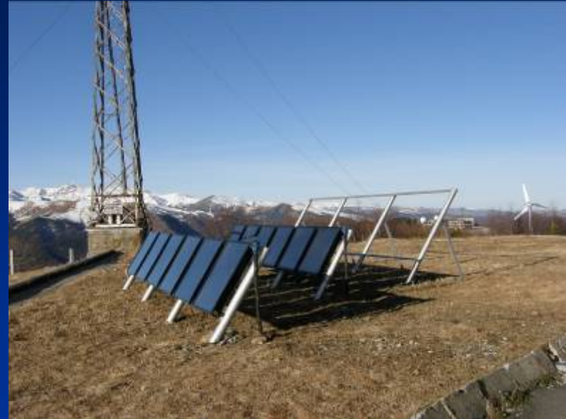
Солнечная установка – запущена осенью, внизу – накопители тепла и блок автоматики для подогрева помещений башни БТА
