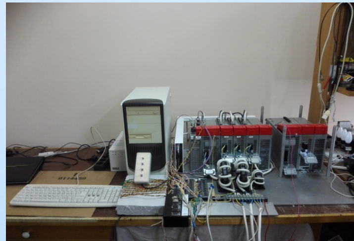
Щит с установленными частотными преобразователями MOVIAxis
